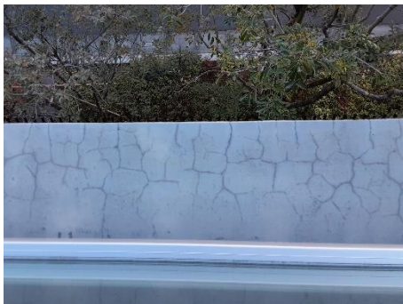
ベランダ手摺上面のひび(下を見た写真)
