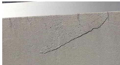
ベランダ手摺外側(左図のひびの先)
