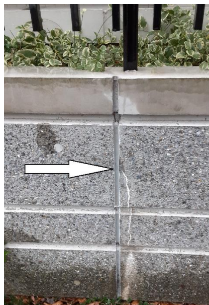
下馬通り外構のコンクリート溶出(エフロレッセンス)
