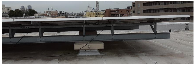
太陽光パネル架台(要修理と判断できない)
