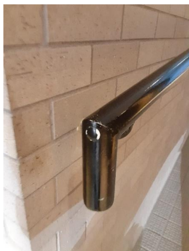
ゴミ室横廊下の手摺
