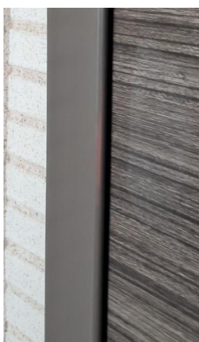
玄関ドア枠。1 次塗装不手際
