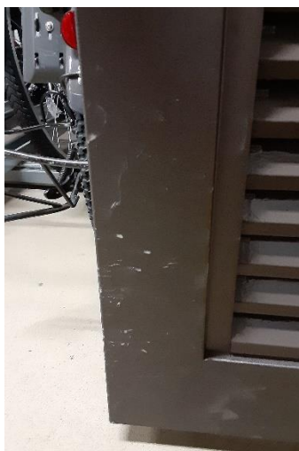
E 棟駐輪場ドア(修理忘れ?)
