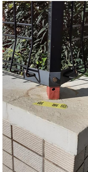
外構コンクリートひび(支柱修理未完)
