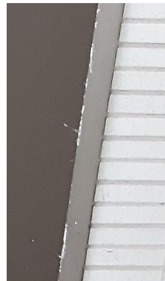
エレベータ出入口
